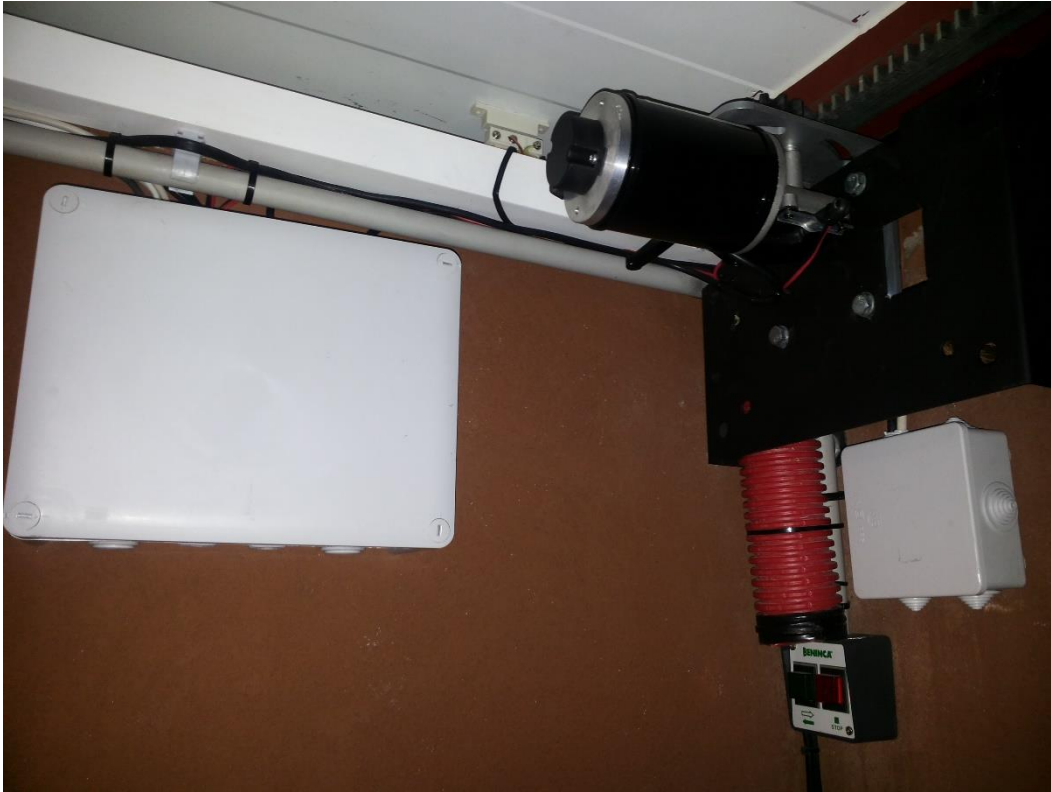
Talon6 instalado en el techo derecho del observatorio
